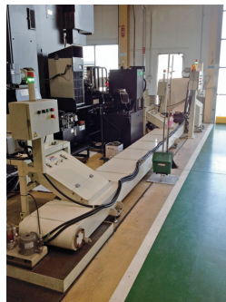
切粉破碎処理システム
