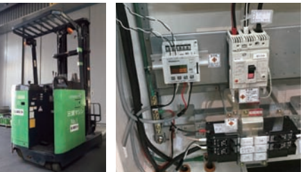
電気リフトのバッテリー残量を電力計測器で見える化
