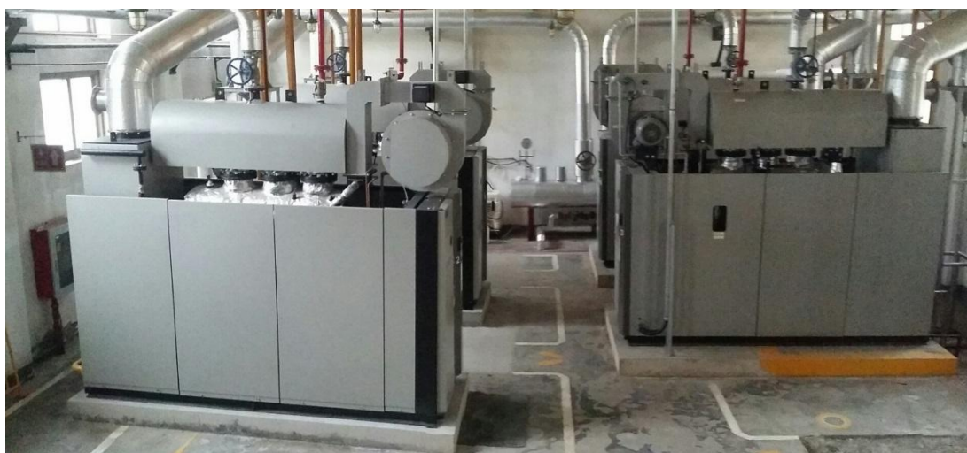
↑ 北京东陶有限公司様 工場内設置写真
