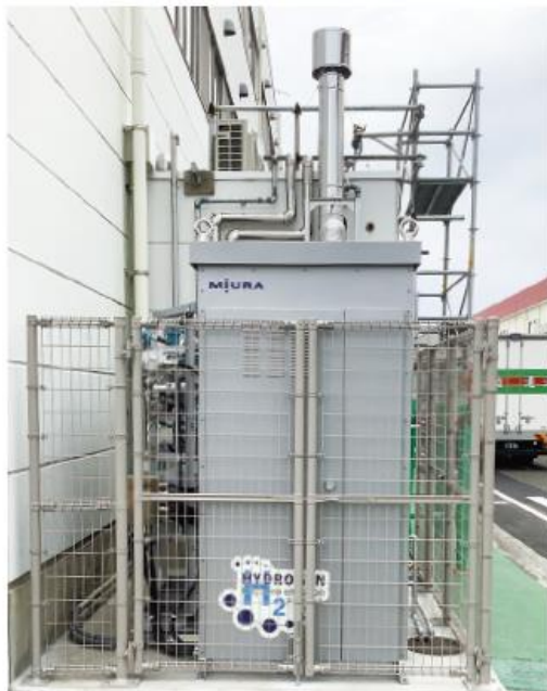
▲水素燃料ボイラ（AN-250×1 台）
