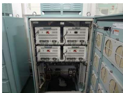
電源盤内部(扉タイプ)
