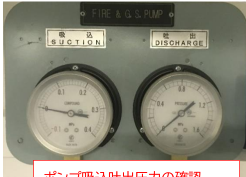
ポンプ吸込吐出圧力の確認
