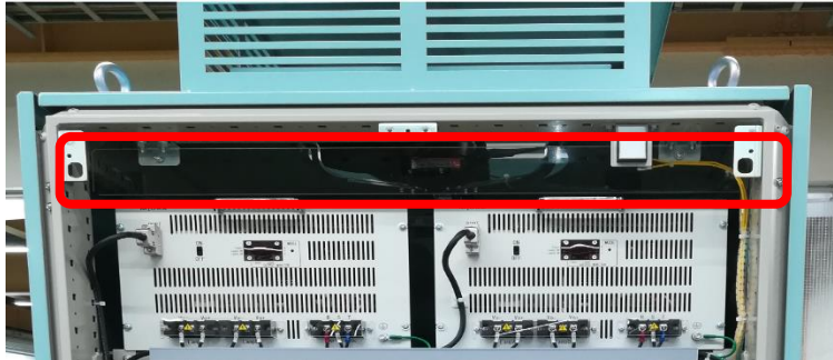
図 2 電源盤上部 アクリル板
